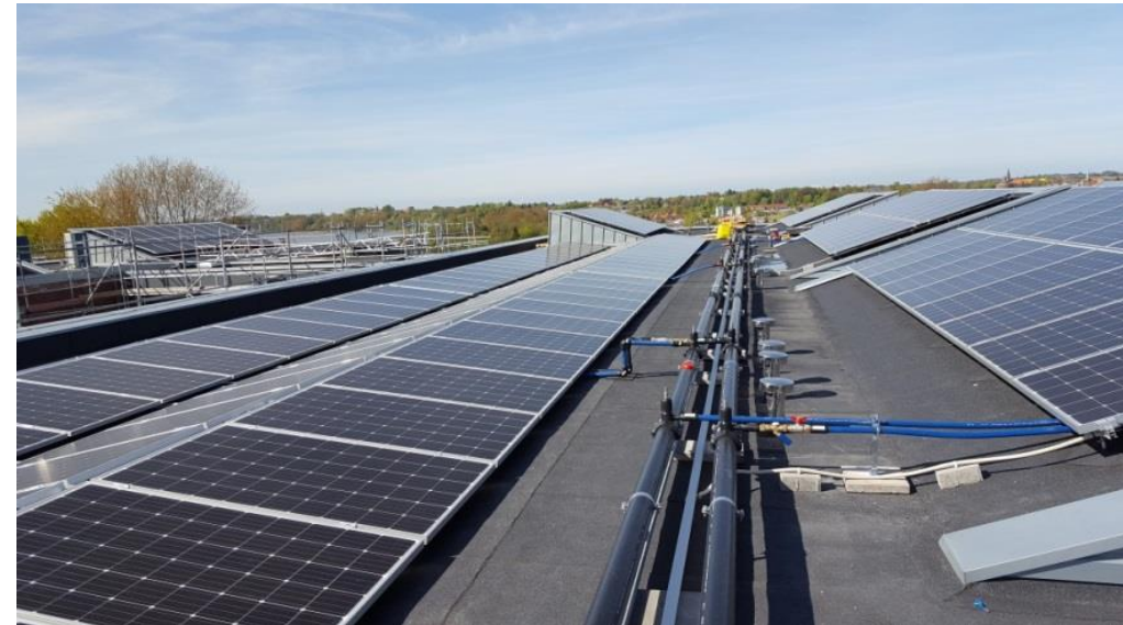
Abbildung 2: Dachabsorber unter PV-Anlage
