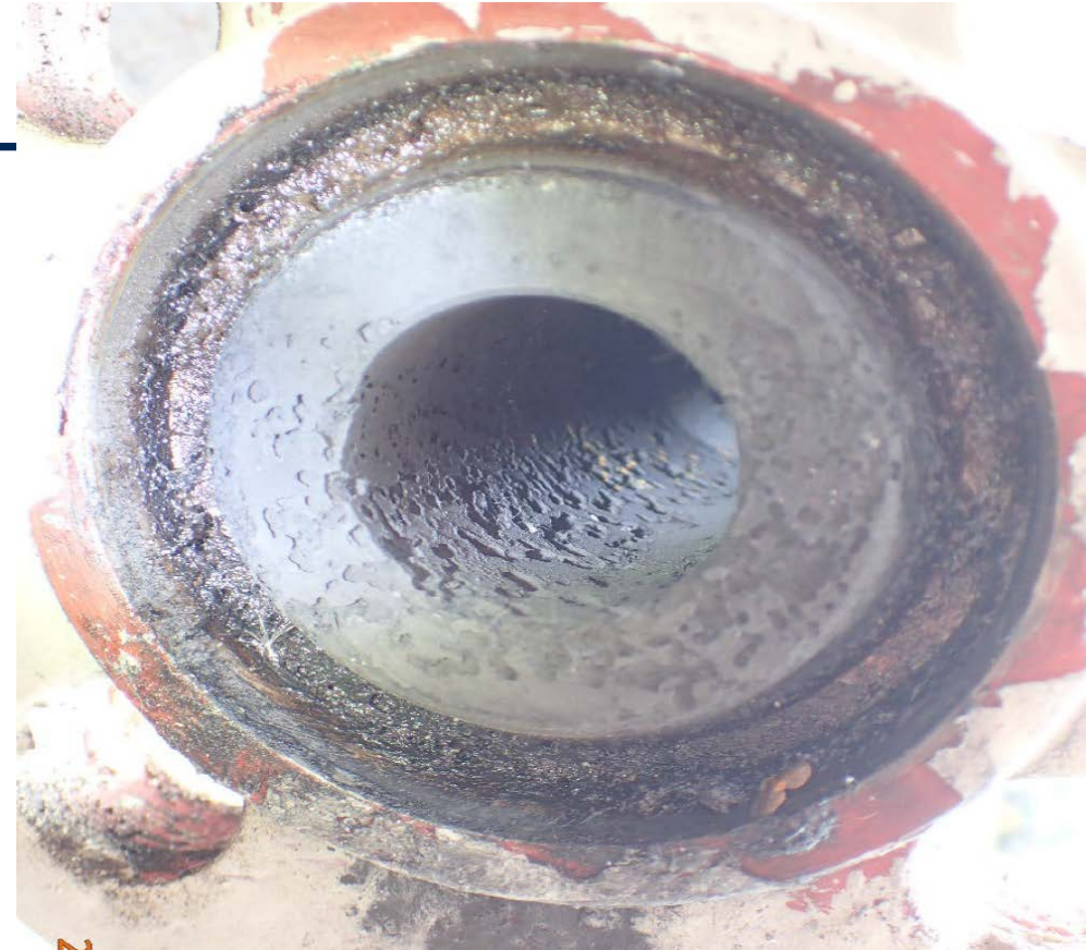
Starke Korrosion am Auslassflansch
