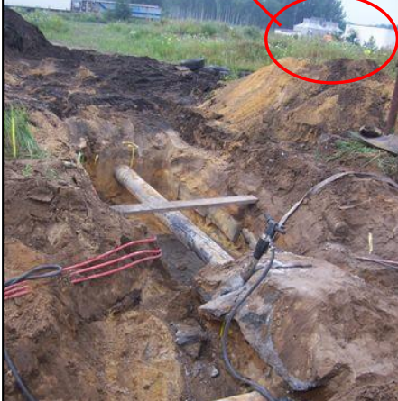
Soleleitung 150 m nach Filterhaus 1
