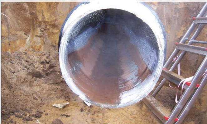
Schwerspatbelag in der Rohrsohle (2-Phasen-Strömung)
